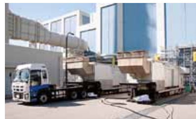
大容量電源車の配備
